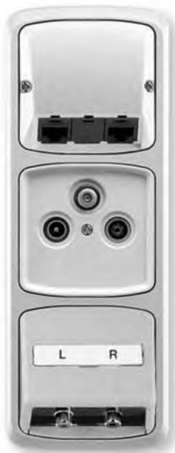
Obr. 89 Reproduktové zásuvky (v dolní části) společně s dalšími sdělovacími zásuvkami
